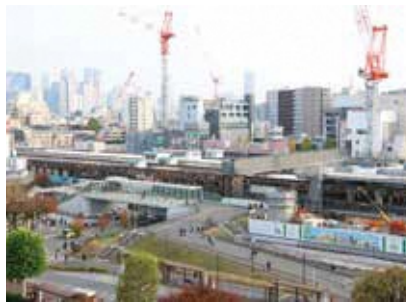
◀西側南北通路・橋上駅舎の整備が進む中野駅。周辺のエリアマネジメントビジョンを策定します
